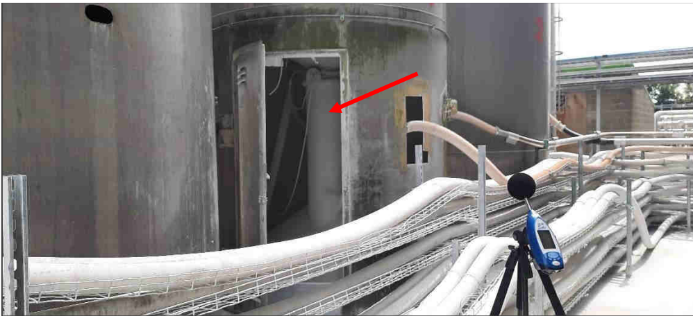
Pompe silo – Pt 20
