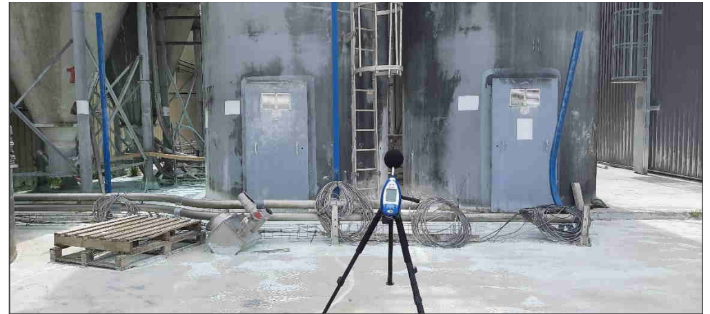
Pompes derrière portes des silos – Pt 19
