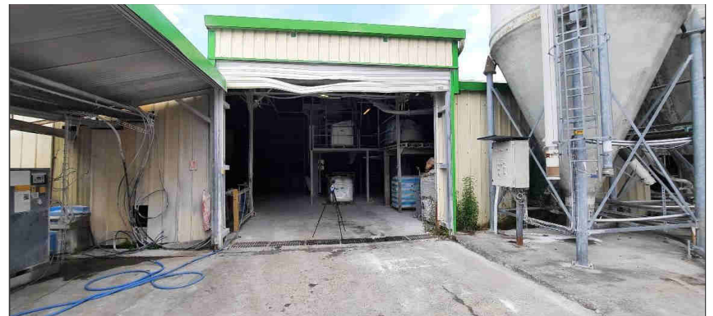
Compresseur et entrée atelier broyeur ouest - Pts 14 et 17
