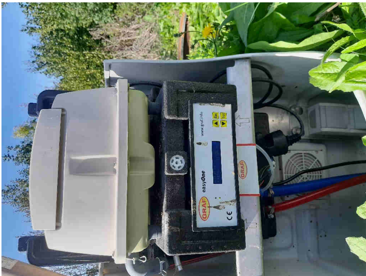
Photo armoire de commande ouverte
